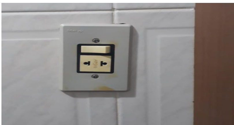
Figura 23: Interruptor e tomada. Fonte: Próprio autor.
