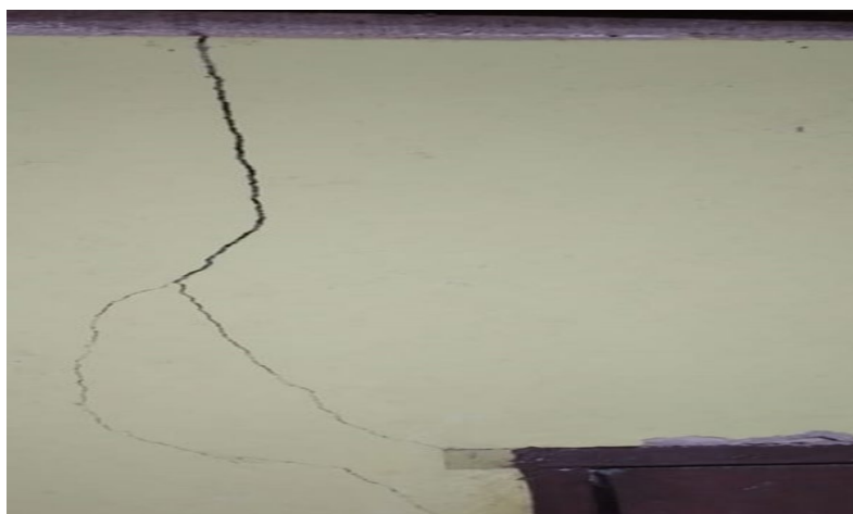
Figura 12: Fissura vertical próxima a abertura. Fonte: Criação do autor (produzido em 2021).
