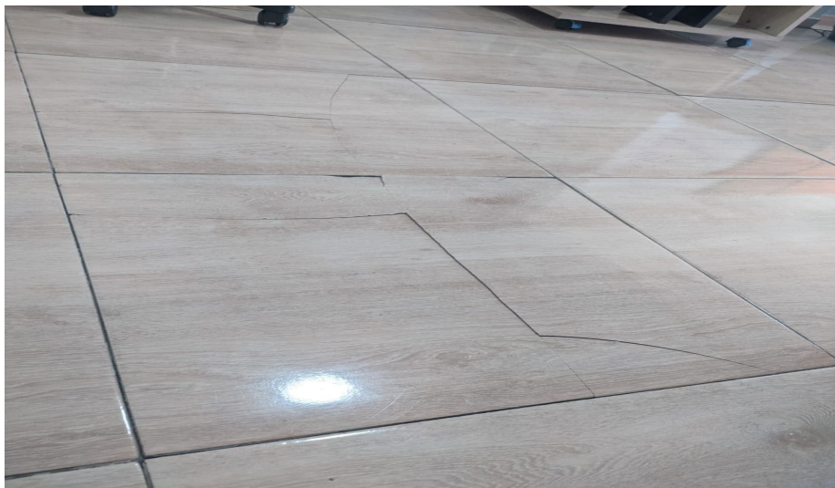
Figura 7: Desplacamento piso cerâmico. Fonte: Criação do autor (produzido em 2021).
