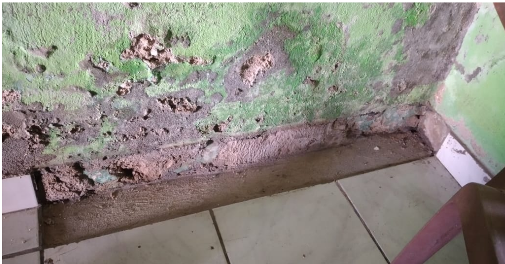
Figura 8: Infiltração por capilaridade. Fonte: Criação do autor (produzido em 2021).
