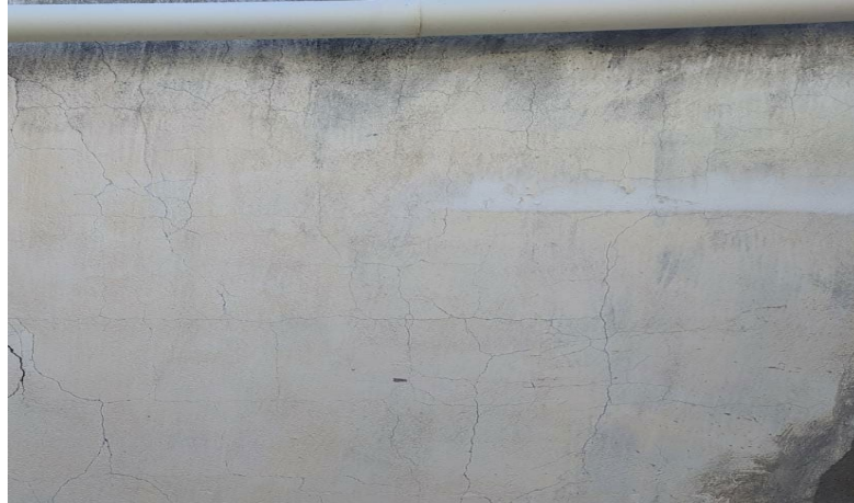
Figura 11: Fissura por retração da argamassa. Fonte: Criação do autor (produzido em 2021).
