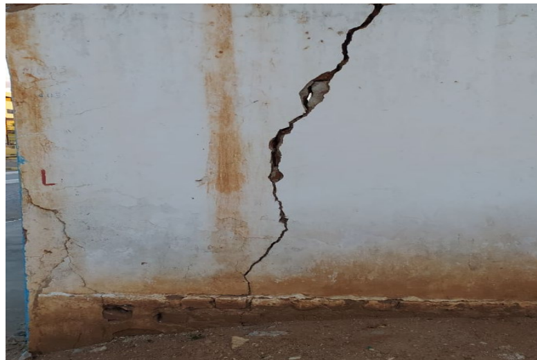
Figura 13: Fissura causada por recalque diferencial. Fonte: Criação do autor (produzido em 2021).
