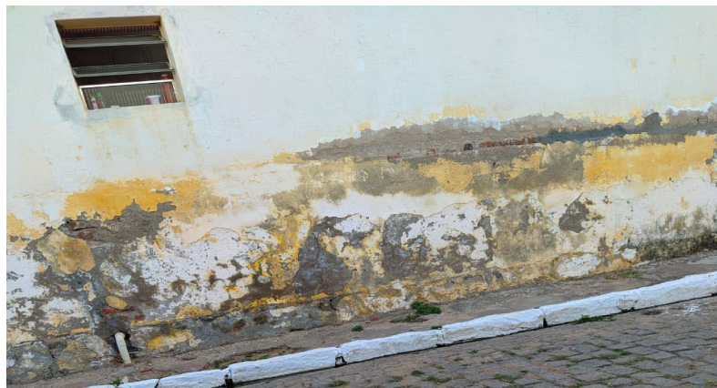
Figura 10: Umidade accidental por ruptura de tubulação de água. Fonte: Criação do autor (produzido em 2021).
